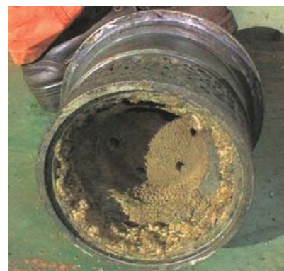
Hình 3. Lắng đọng muối trong van tiết lưu C1-2 trên đường ống bơm dầu từ CTP-2
